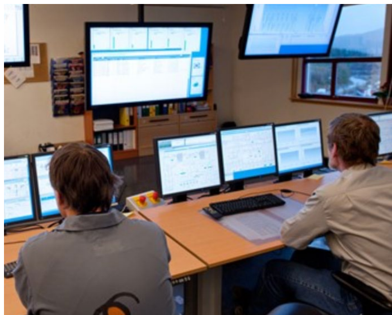
Vid BIRs forbr nningsanl gning R dalen i Bergen, som drivs 24 timmar om dygnet, 365 dagar om  ret,  vervakes anl gningen kontinuerligt av sertifiserade medarbetare fr n ett modernt kontrollrum. Bild: BIR Avfallsenergi AS
