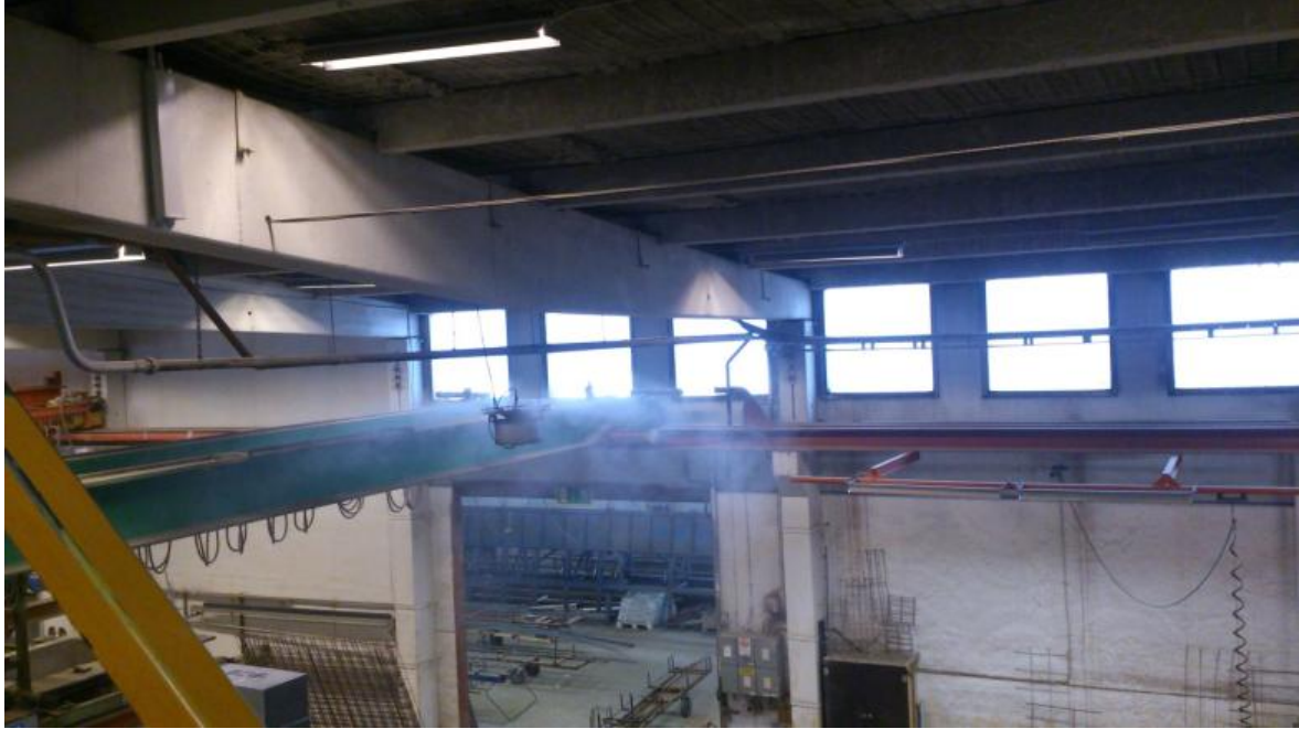
Foto: Ett dis syns under taket, vilket indikerar att allmänventilationen skulle kunna fungera bättre.
