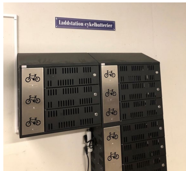
Figur 10. För ökad brandsäkerhet förvaras laddstation för cykelbatterier i låsbara skåp i källaren. Foto: Familjebostäder
