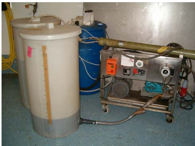
Figur 4.4. RO-anläggningen samt uppsamlingskärnen.
